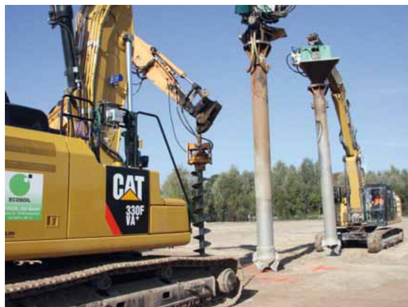
Über Cat Baumaschinen samt Aufsatzrüttler und Schleusenrohr wurden Stopfsäulen bis in fünf Metern Tiefe, in einem vorgegebenen Raster und mit einem Durchmesser von durchschnittlich 60 Zentimetern angelegt.
